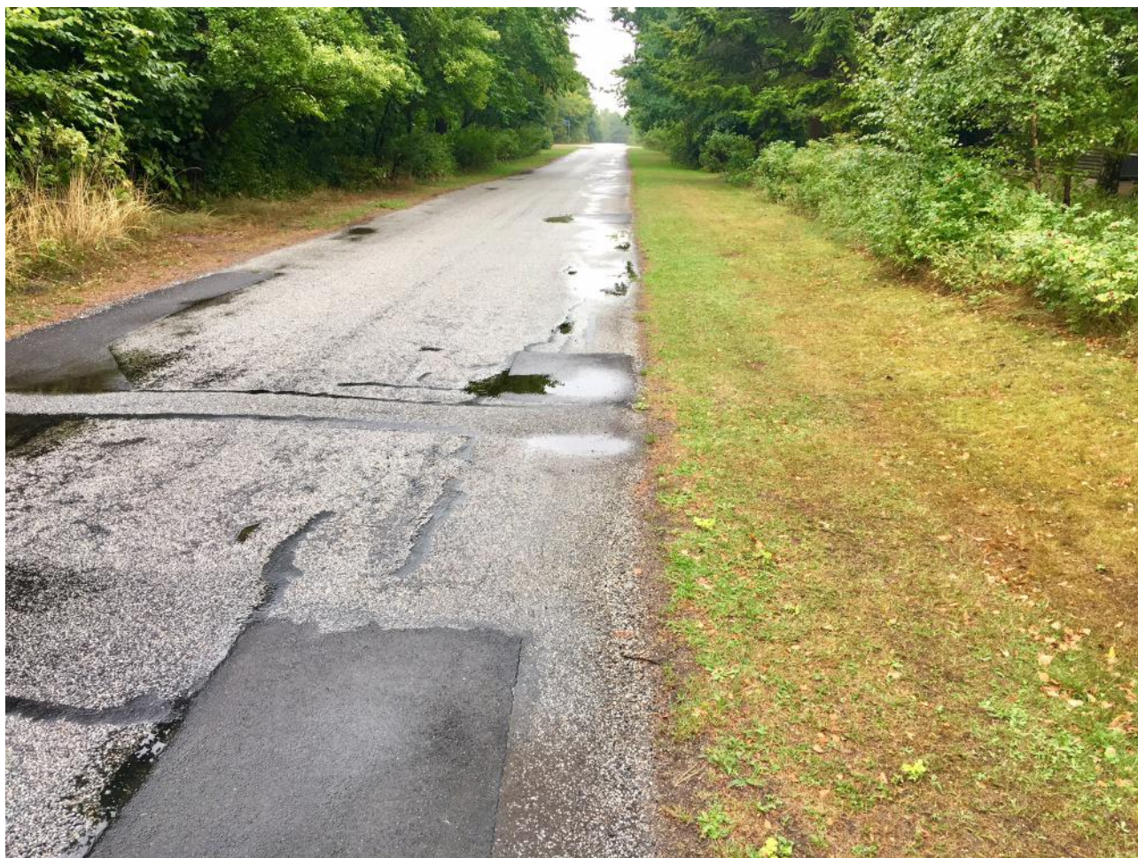
Foto nr. 5: Hostrupsvej mellem Kærvej og Hyremandsvej, set mod øst op mod Hyremandsvej Vandpytter på Hostrupsvej i begge sider ud for Kærvej nr. 1 og Hyremandsvej nr. 2 Hostrupsvej er ret flad her
