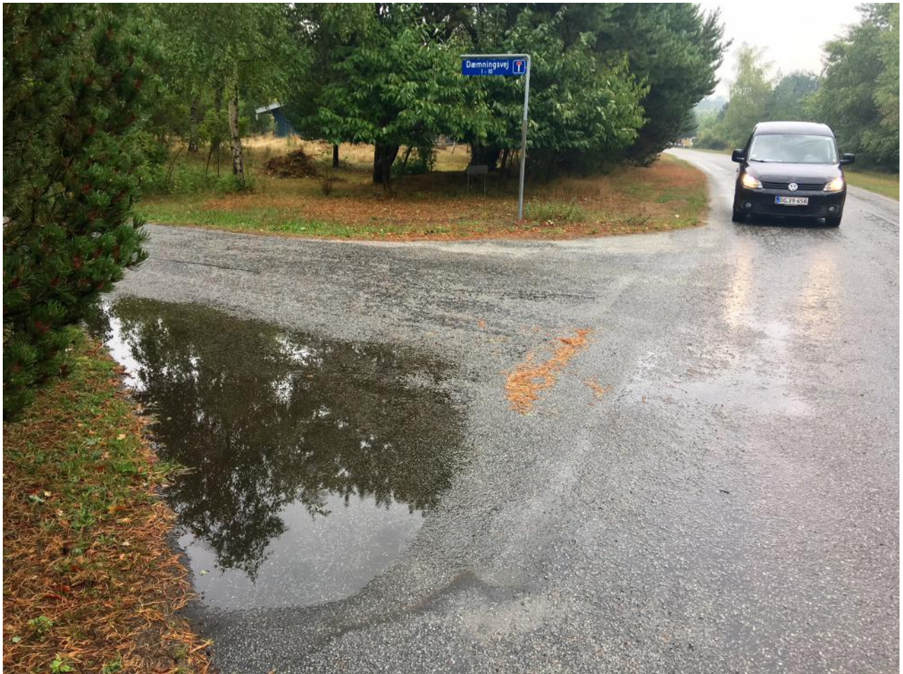
Foto nr. 6: Hostrupsvej set mod øst ved Dæmningsvej sidevejstilslutning Vejskilt på hjørnet ud for Dæmningsvej nr. 9 Meget stor vandpyt på Dæmningsvej og lidt rundt om hjørnet til Hostrupsvej ud for Dæmningsvej nr. 10 Denne del af Dæmningsvej har fald ned mod Hostrupsvej
