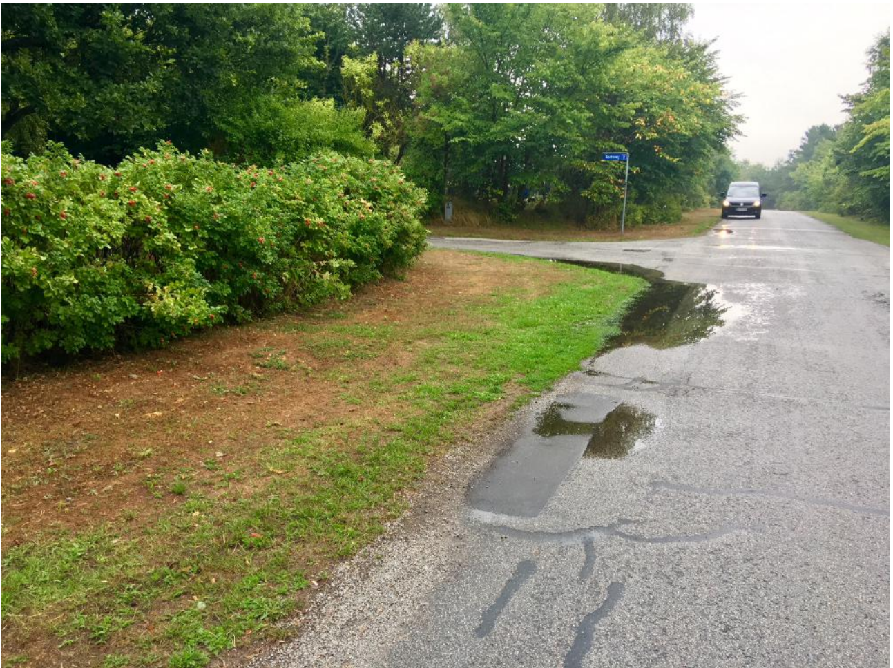
Foto nr. 8: Hostrupsvej set mod øst ved Kortevejs sidevejstilslutning Vejskilt på hjørnet ud for Kortevej nr. 2 Meget stor vandpyt på Hostrupsvej og rundt om hjørnet til Kortevej ud for Kortevej nr. 1 Kortevej har fald ned mod Hostrupsvej
