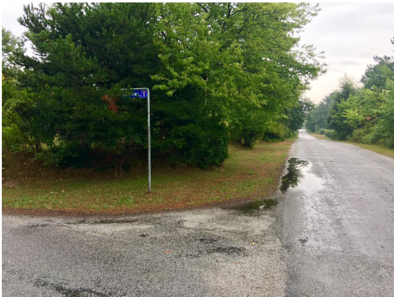
Foto nr. 10: Hostrupsvej set mod øst ved Granhøj sidevejstilslutning Vejskilt på hjørnet ud for Granhøj nr. 2 Vandpytter på Hostrupsvej og rundt om hjørnet til Granhøj ud for Granhøj nr. 2 Granhøj har fald ned mod Hostrupsvej
