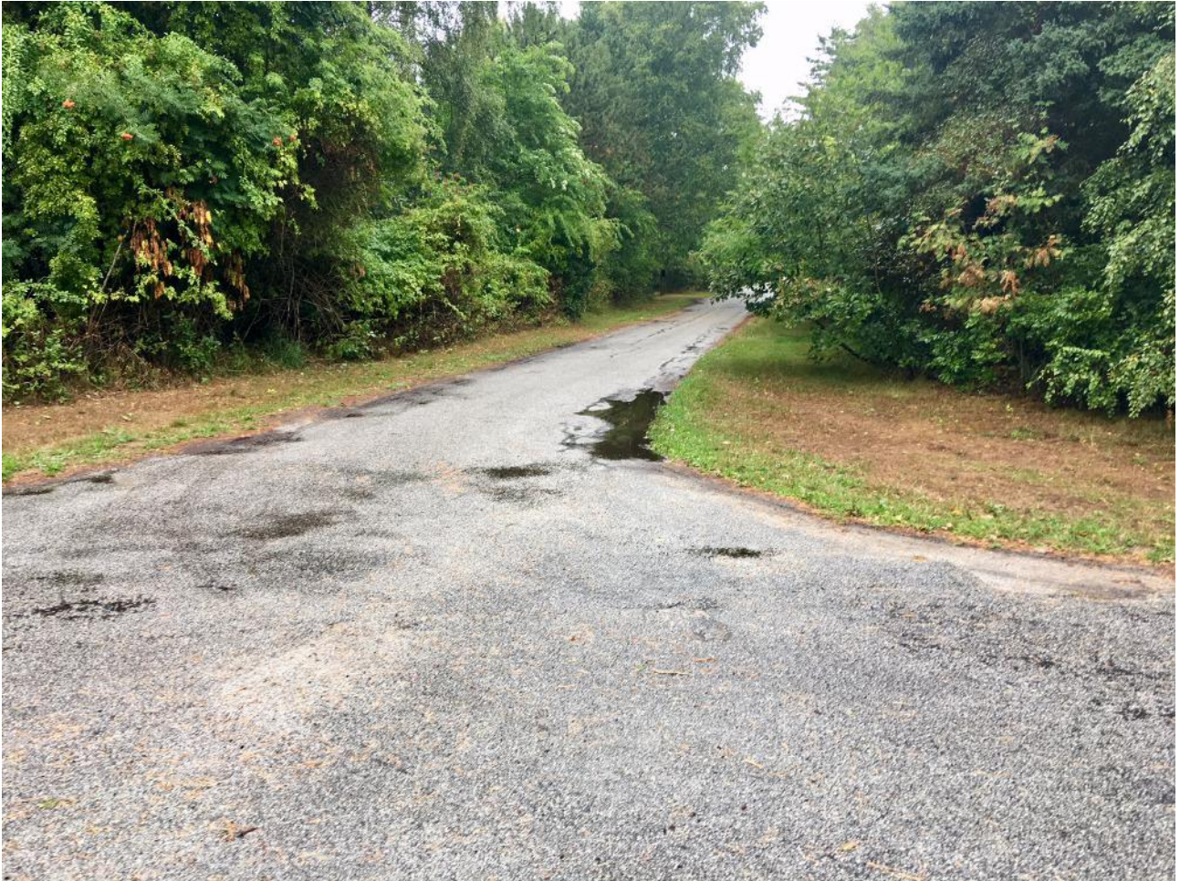
Foto nr. 2: Virmandsvej set mod nord op mod Hostrupsvej Vandpyt på Virmandsvej på hjørnet ud for nr. 7 Virmandsvej har fald ned mod det sted, hvor foto er taget, dvs. mod syd
