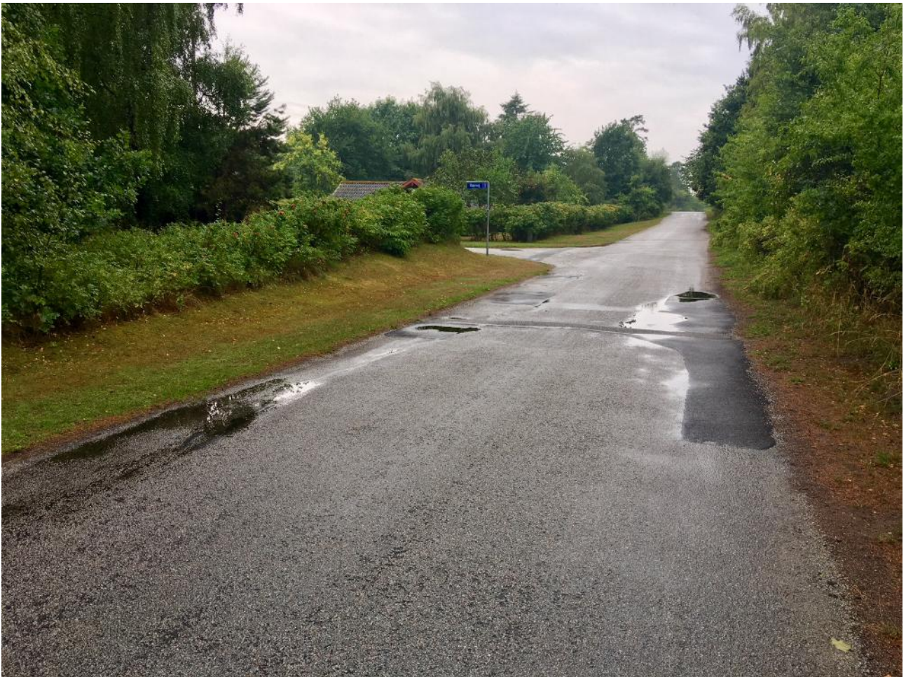
Foto nr. 9: Hostrupsvej set mod vest hen mod Kærvejs sidevejstilslutning Vejskilt på hjørnet ud for Kærvej nr. 1 Vandpytter på Hostrupsvej i begge sider ud for Hostrupsvej nr. 17 og Kærvej nr. 1 Hostrupsvej er ret flad her
